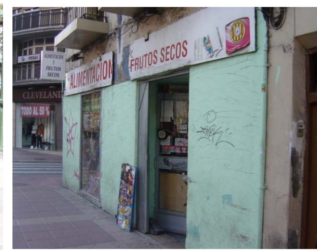
Fachadas comerciales deterioradas, afectan a la imagen comercial global.
