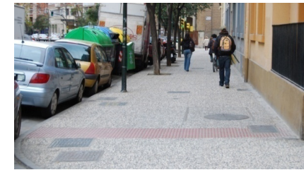
Pavimento de terrazo de estado de conservación medio aunque con tramos puntuales a reparar.
